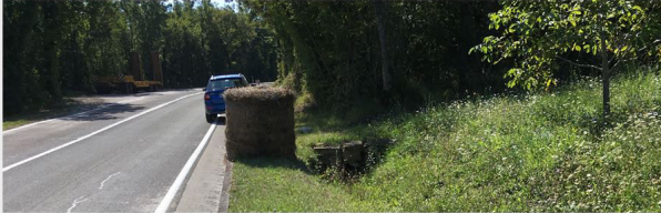
Beton drenaj korumasız
